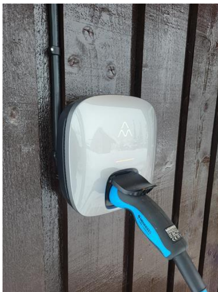
Elektrisk anlegg - [Elbillader på vegg]
