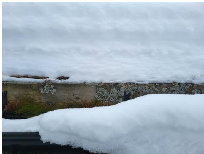
Utvendig - [Slitasje på torvhaldsbord]
