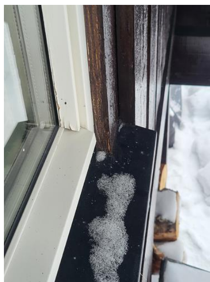
Utvendig - [Slitasje på glasslister]
